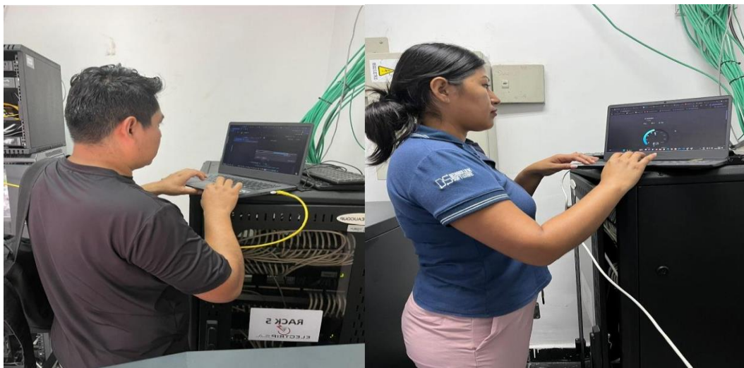
Figura 14 Testeo de la fibra óptica
