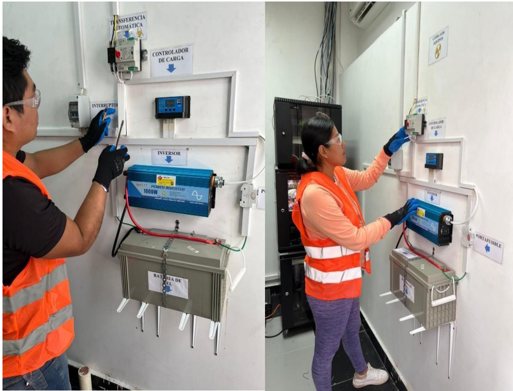
Figura 16 Instalación eléctrica del Cuarto de Comunicación
